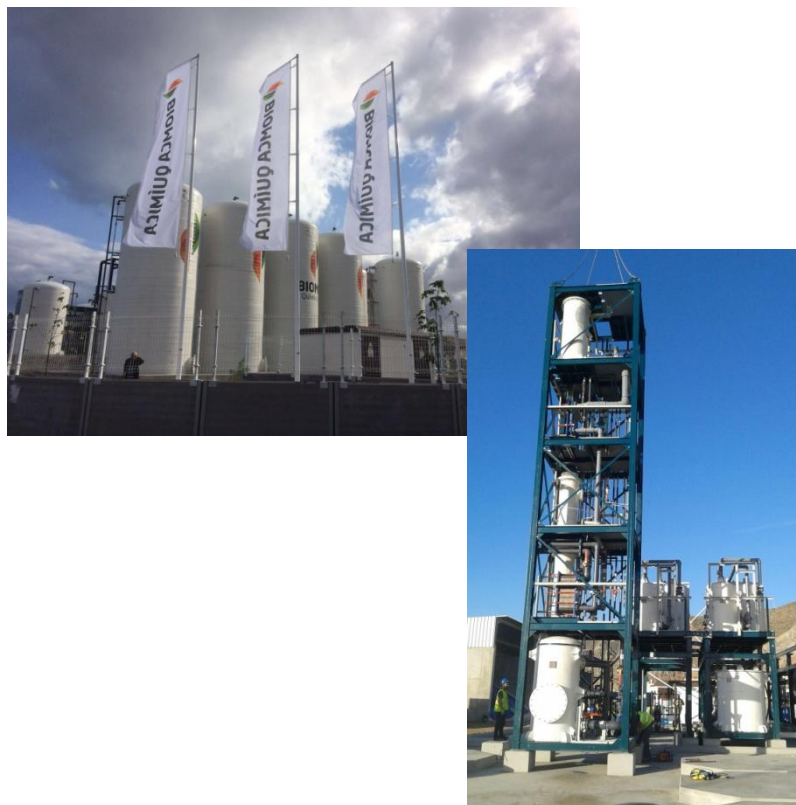
Infraestructura energética de una fábrica de hiperclorito
