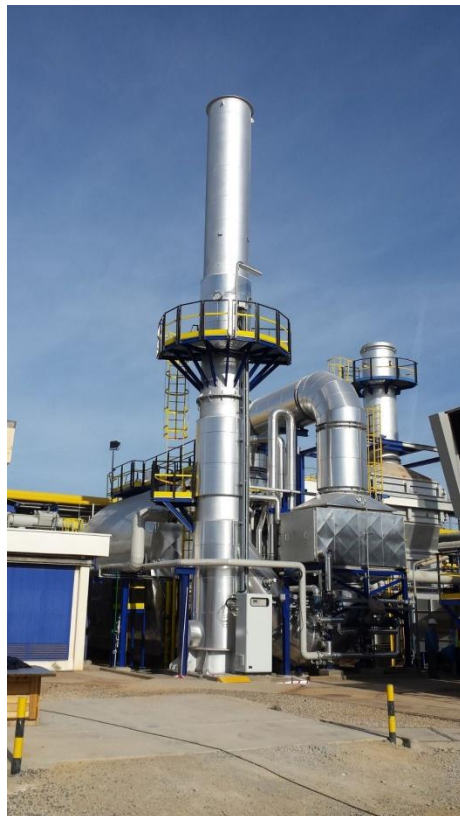
Caldera de Vapor de 40tn/h con gas natural
